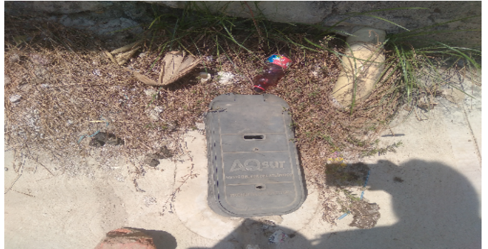
Contador de Agua
