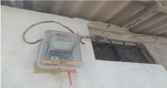
Contador de Energia
