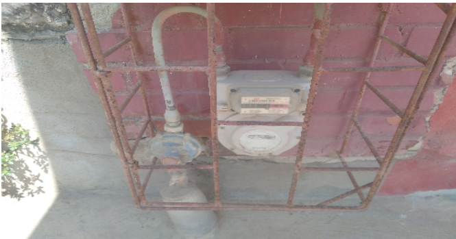
Contador de Gas
