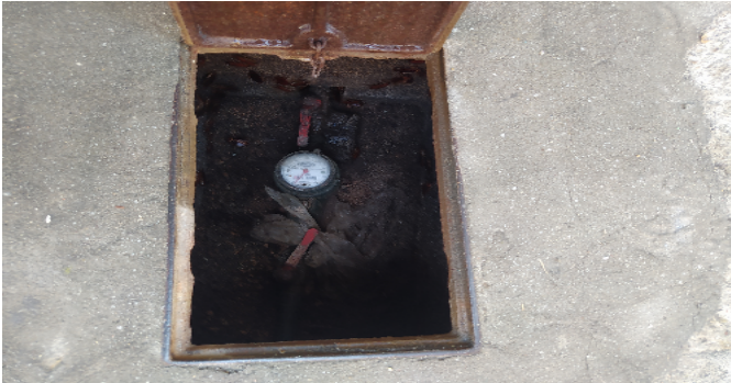
Contador de Agua
