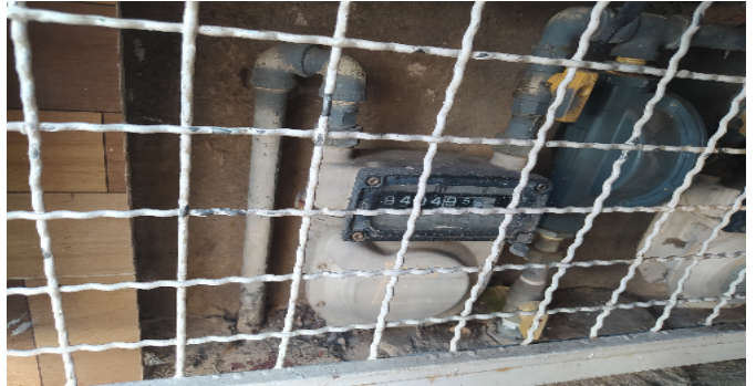
Contador de Gas
