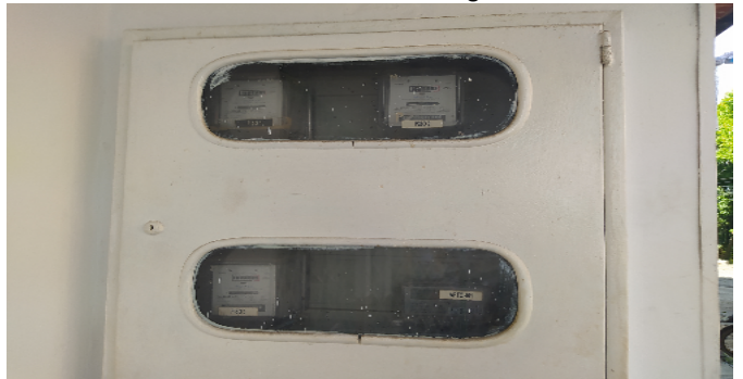
Contador de Energia
