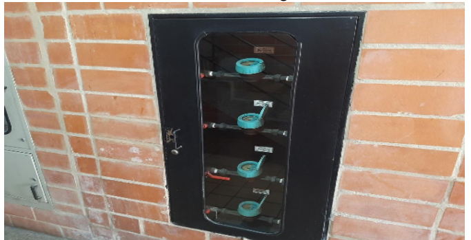
Contador de Agua
