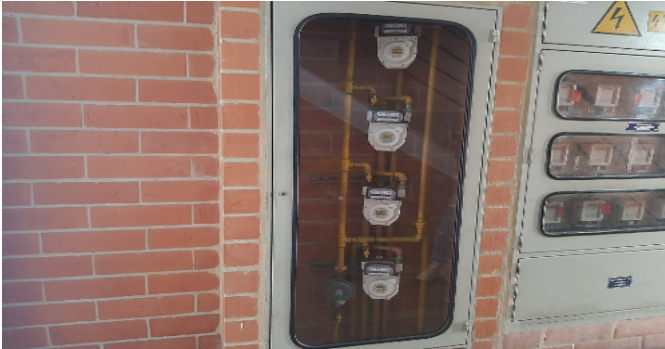
Contador de Gas
