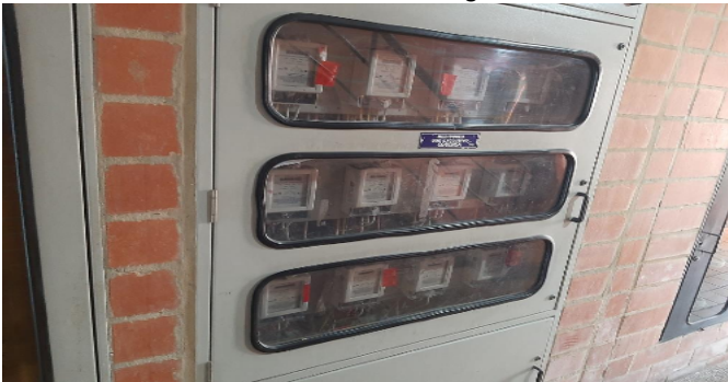
Contador de Energia
