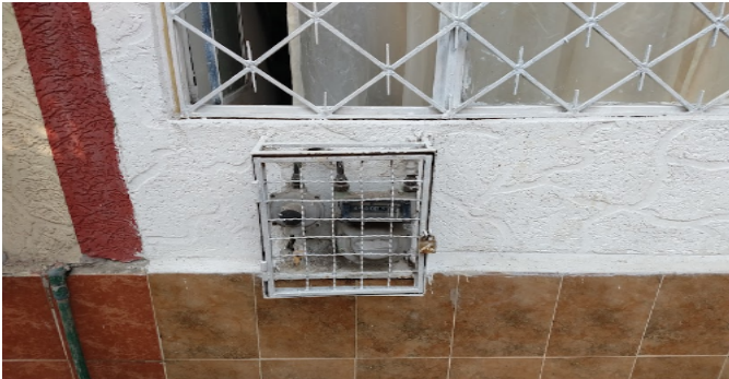
Contador de Gas
