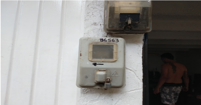
Contador de Energia
