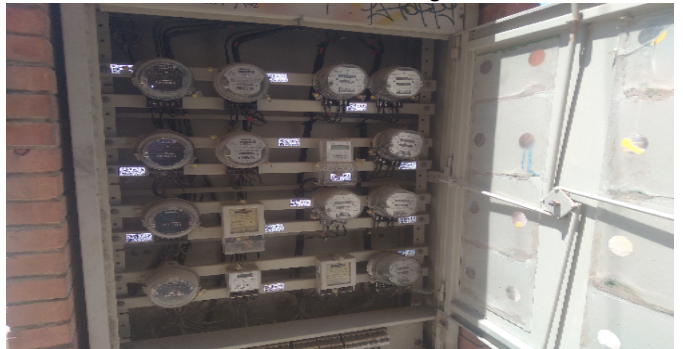
Contador de Energia
