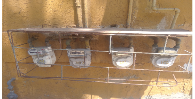
Contador de Gas
