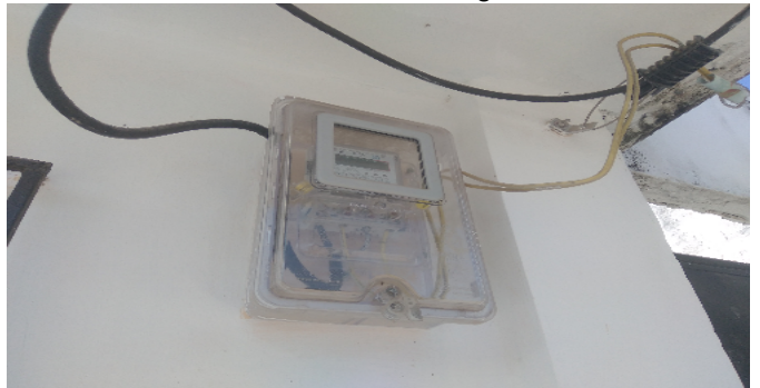
Contador de Energia
