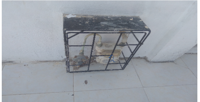
Contador de Gas
