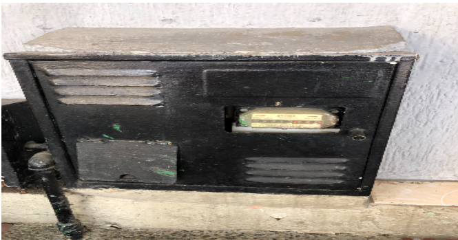
Contador de Gas
