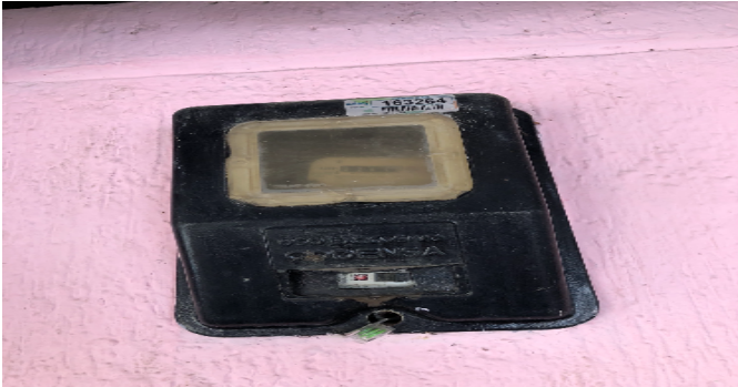
Contador de Energia
