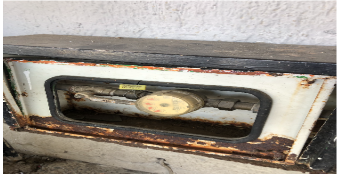
Contador de Agua
