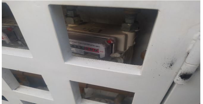
Contador de Gas
