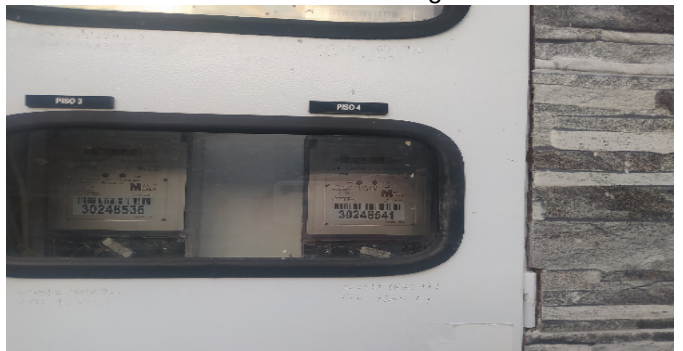
Contador de Energia
