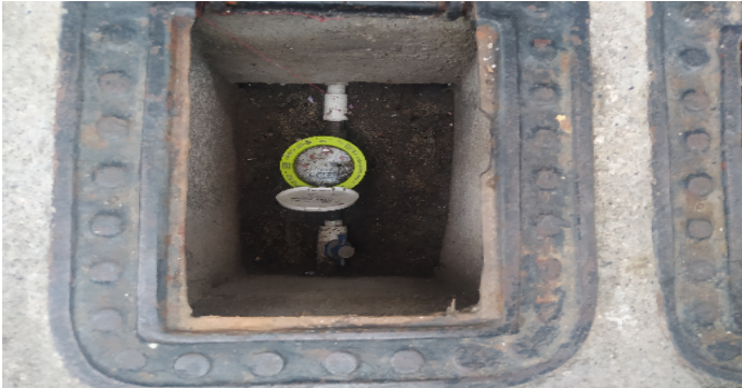
Contador de Agua
