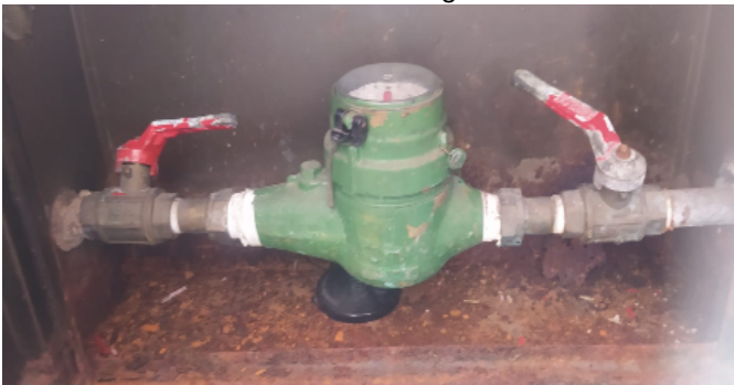
Contador de Agua
