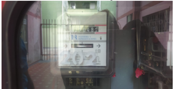
Contador de Energia
