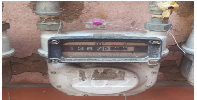
Contador de Gas
