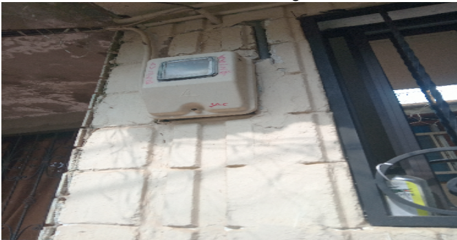
Contador de Energia
