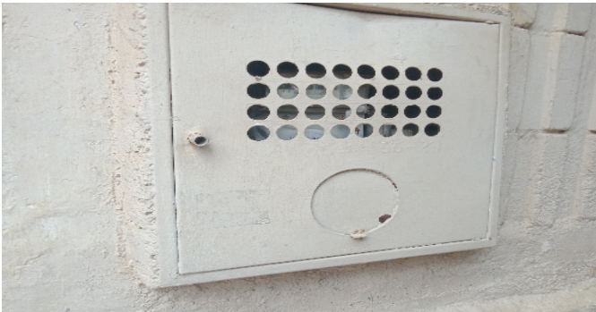
Contador de Gas
