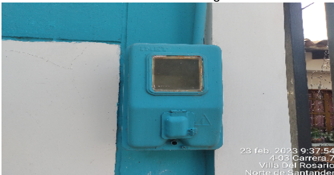
Contador de Energia
