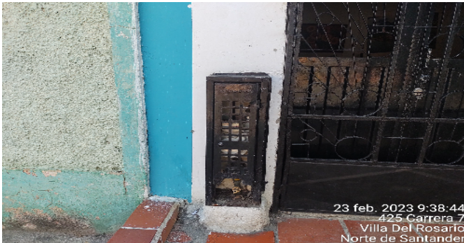
Contador de Gas
