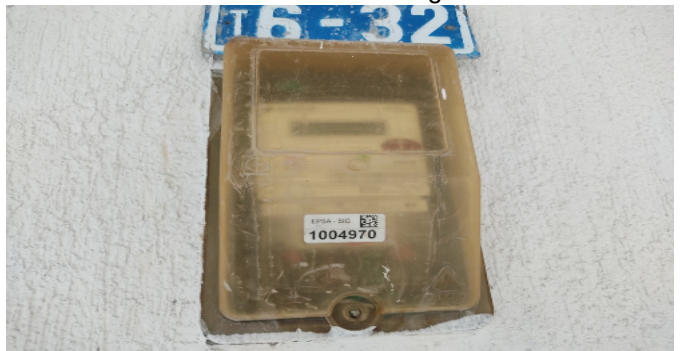
Contador de Energia
