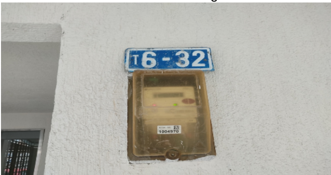
Contador de Energia
