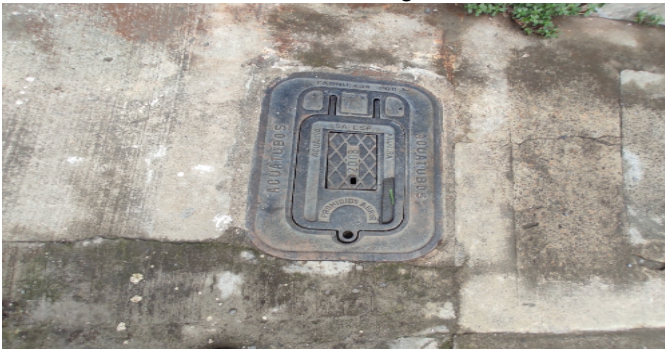
Contador de Agua
