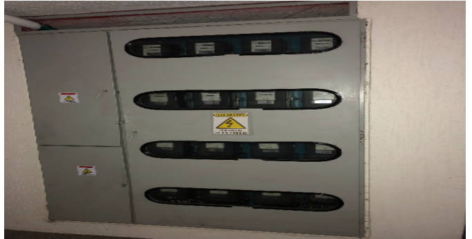
Contador de Energia
