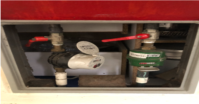
Contador de Agua
