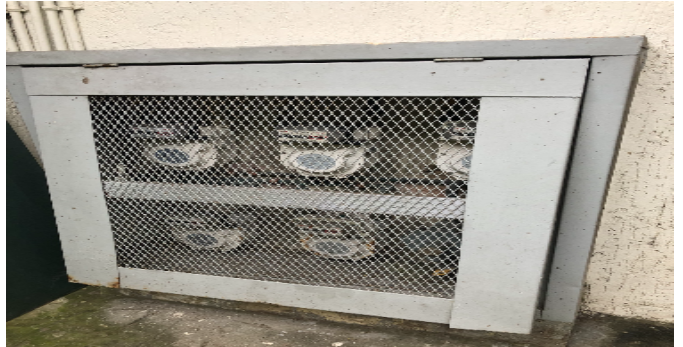
Contador de Gas
