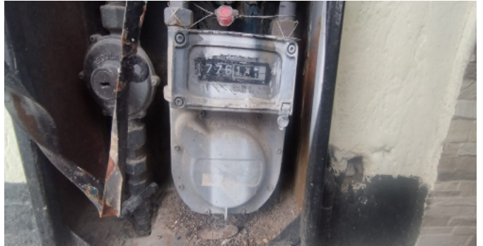
Contador de Gas
