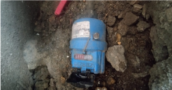
Contador de Agua
