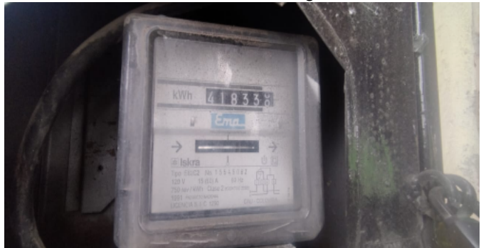
Contador de Energia
