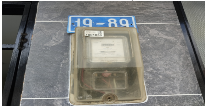
Contador de Energia
