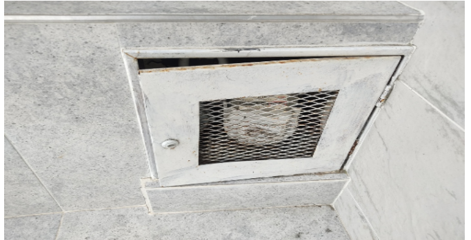
Contador de Gas
