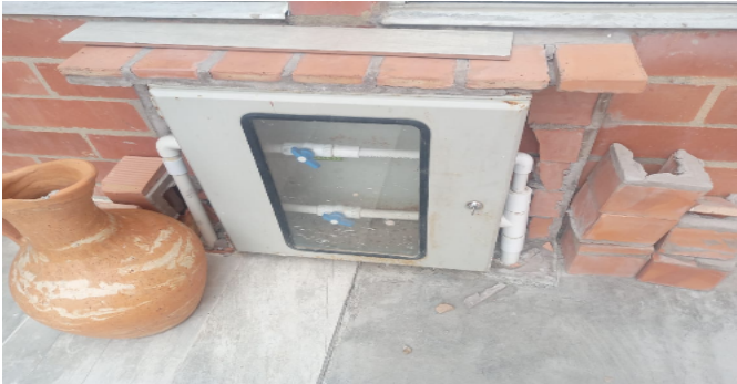
Contador de Agua
