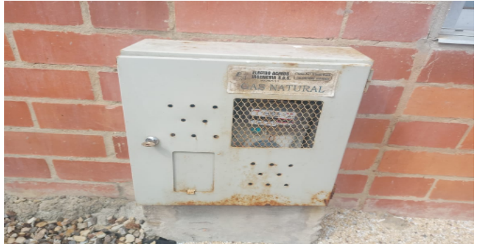
Contador de Gas
