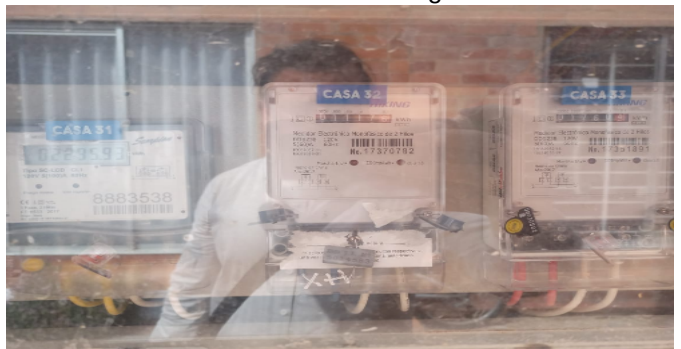
Contador de Energia
