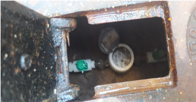
Contador de Agua
