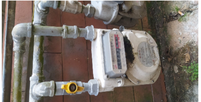
Contador de Gas
