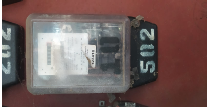
Contador de Energia
