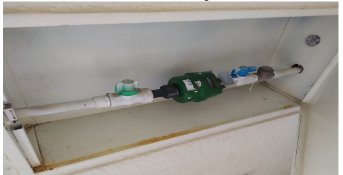
Contador de Agua
