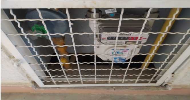
Contador de Gas
