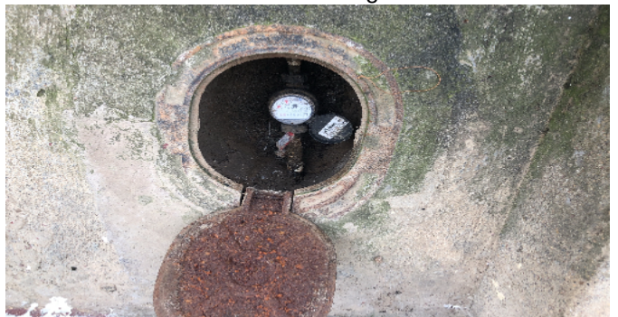
Contador de Agua
