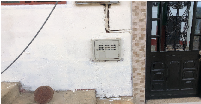
Contador de Gas
