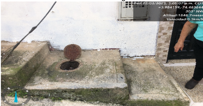
Contador de Agua
