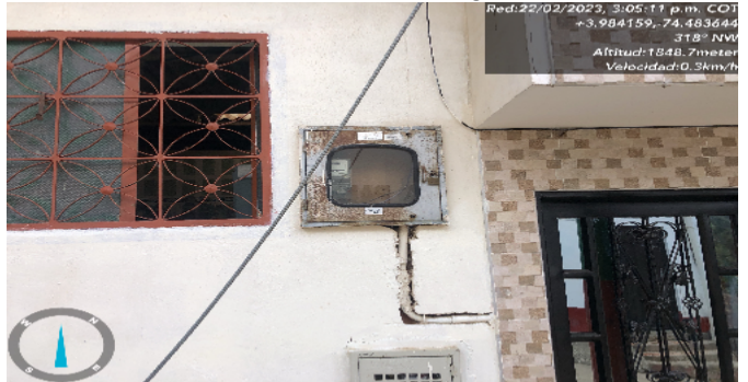
Contador de Energia
