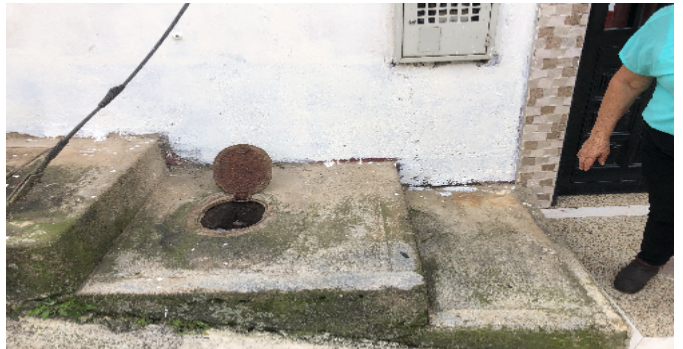
Contador de Gas
