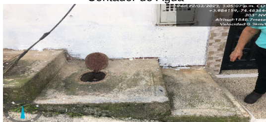
Contador de Agua
