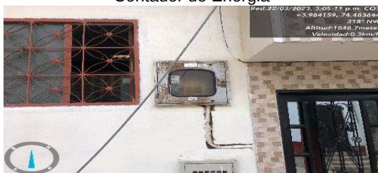
Contador de Energia
