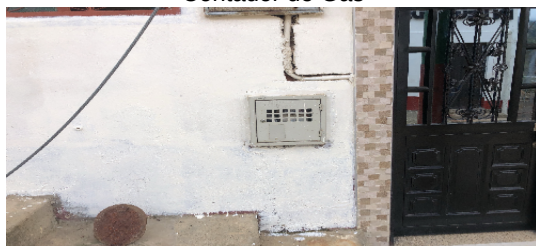
Contador de Gas
