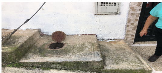
Contador de Gas
