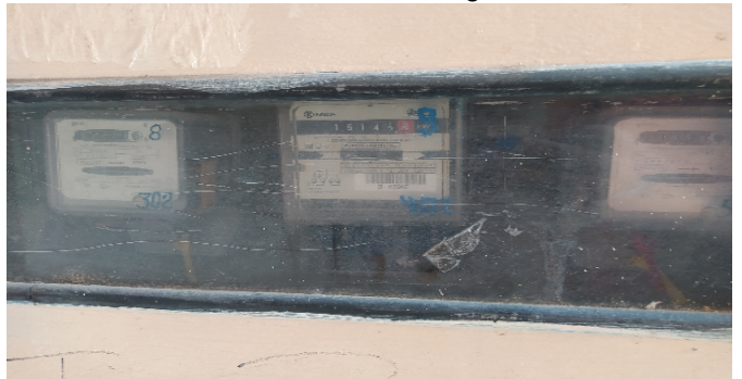
Contador de Energia
