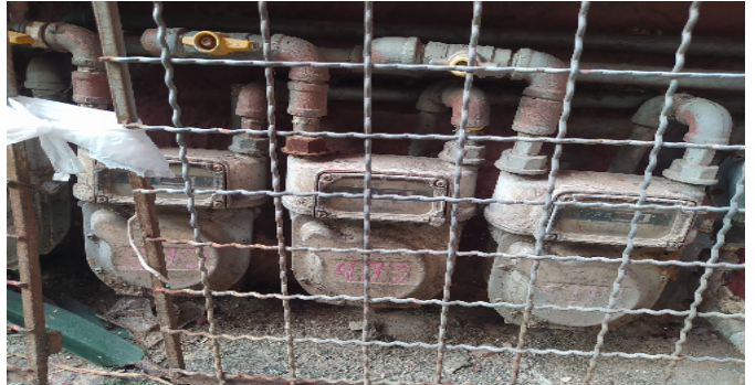
Contador de Gas
