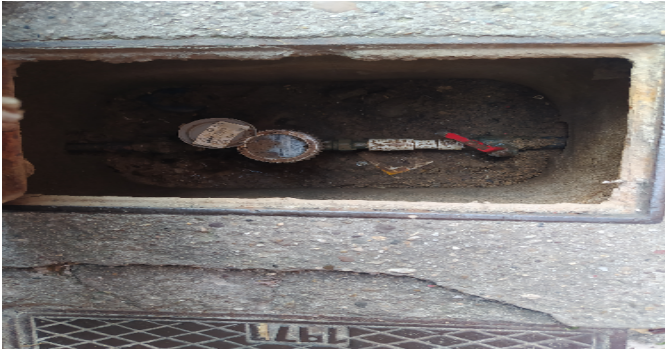
Contador de Agua
