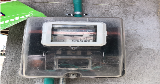
Contador de Energia
