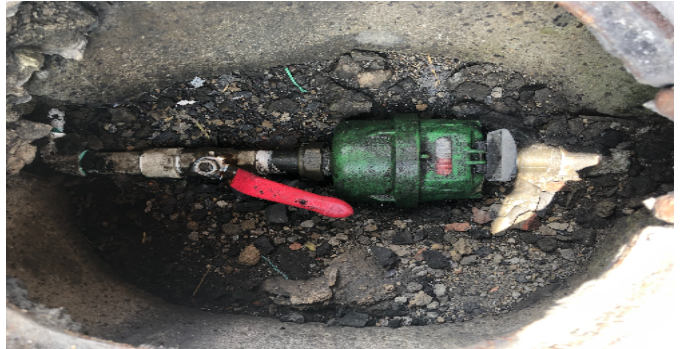
Contador de Agua
