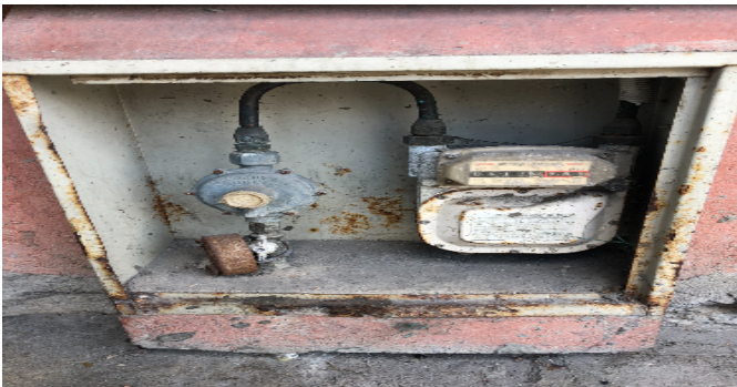
Contador de Gas
