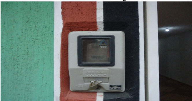
Contador de Energia
