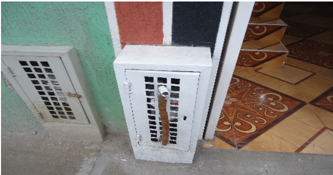
Contador de Gas
