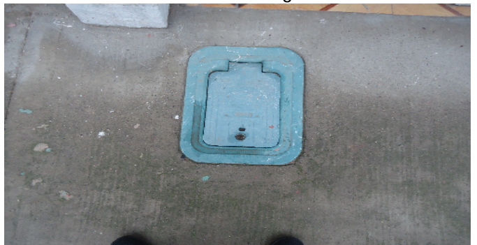
Contador de Agua
