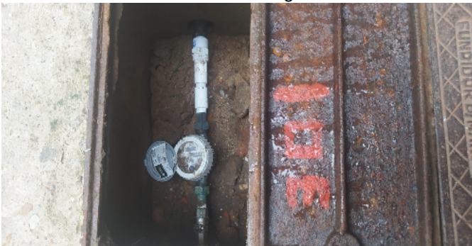
Contador de Agua
