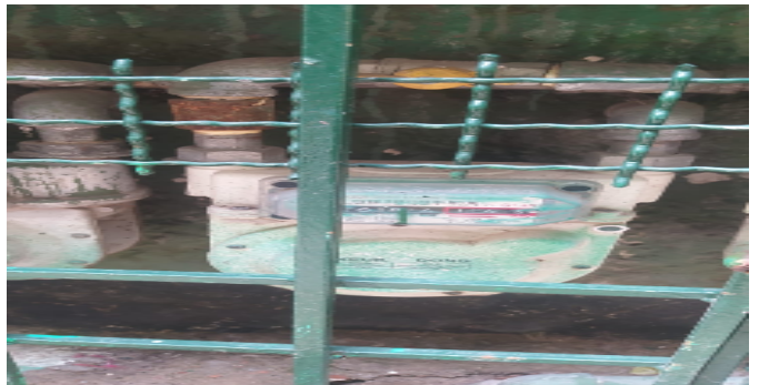
Contador de Gas
