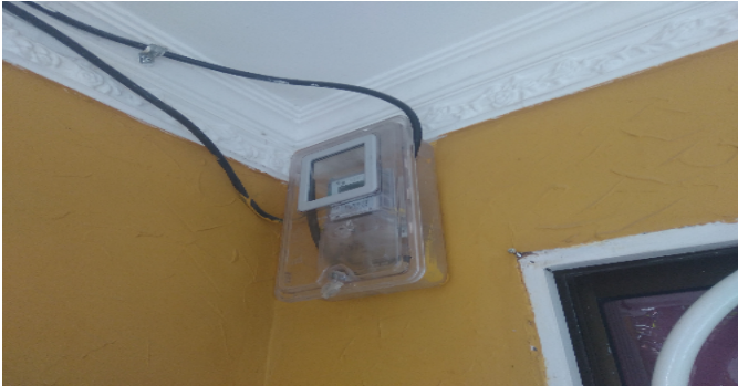
Contador de Energia
