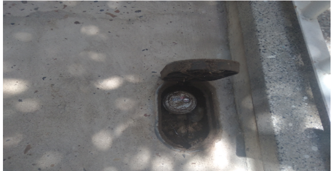
Contador de Agua
