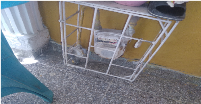
Contador de Gas
