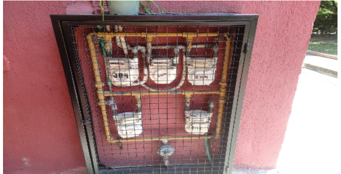
Contador de Gas
