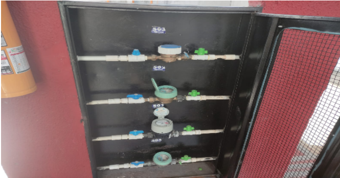
Contador de Agua
