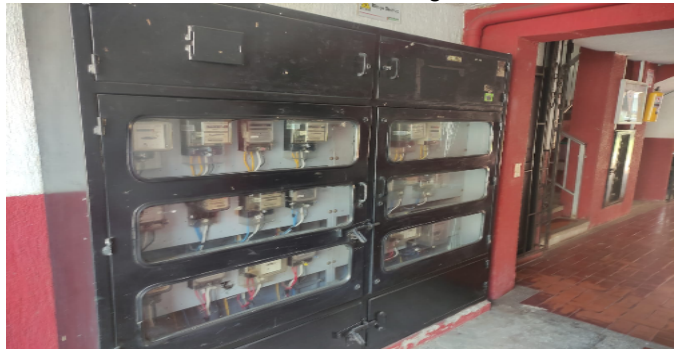
Contador de Energia
