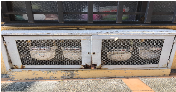
Contador de Gas
