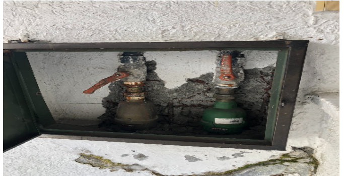
Contador de Agua
