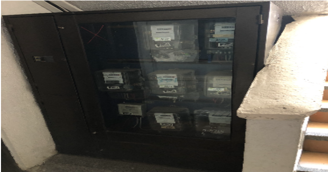
Contador de Energia
