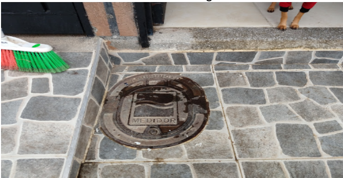
Contador de Agua
