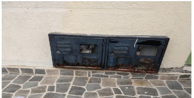
Contador de Gas
