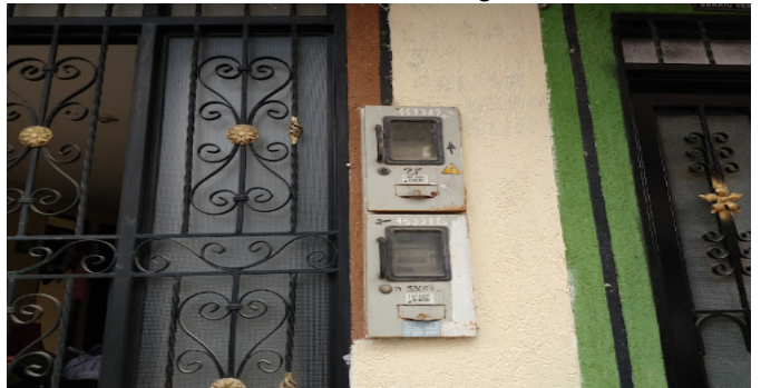
Contador de Energia
