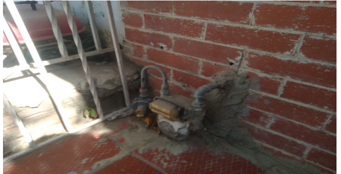
Contador de Gas
