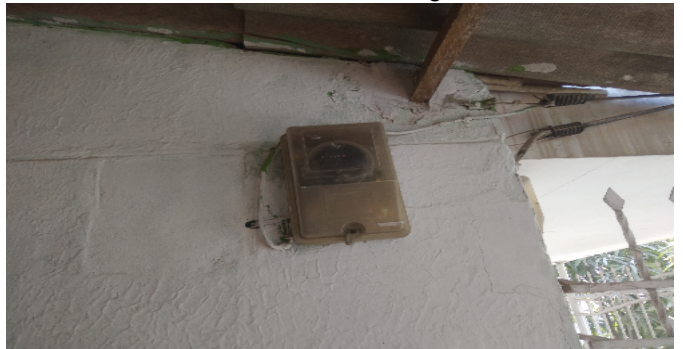
Contador de Energia
