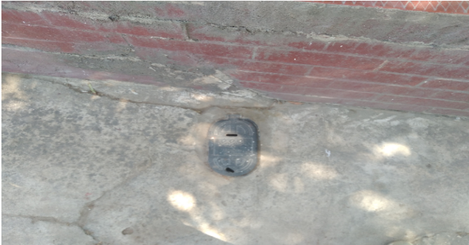
Contador de Agua
