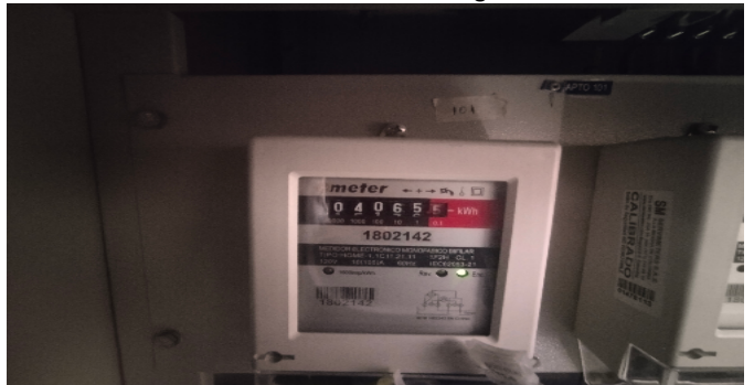
Contador de Energia
