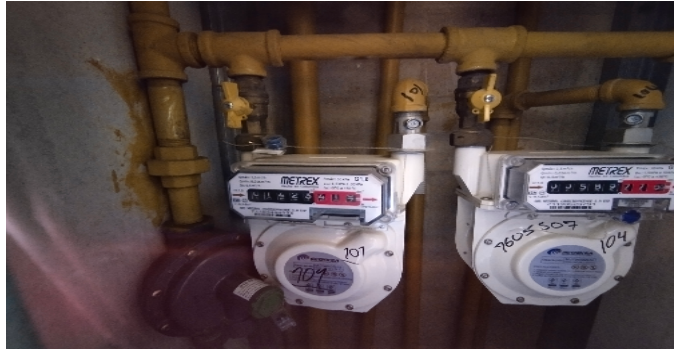
Contador de Gas
