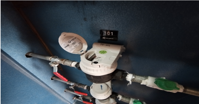
Contador de Agua
