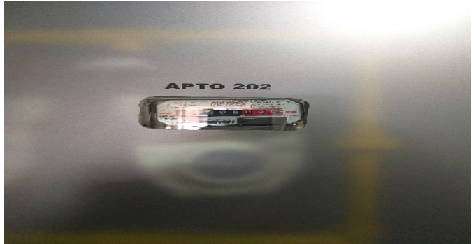
Contador de Gas
