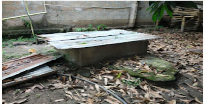
Contador de Agua
