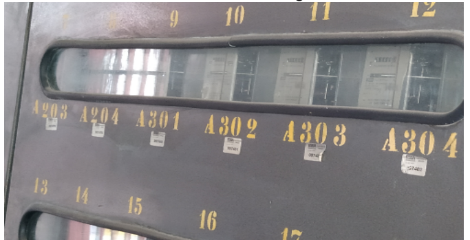
Contador de Energia
