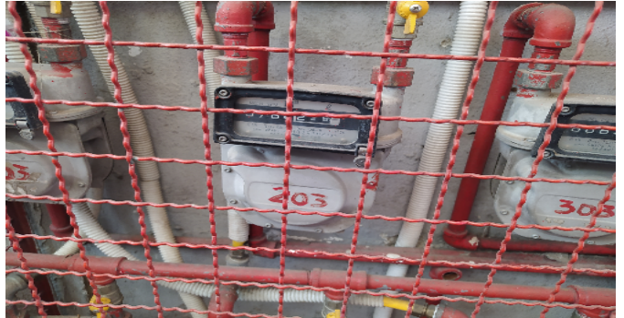
Contador de Gas
