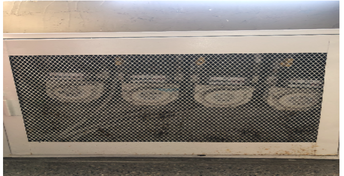
Contador de Gas
