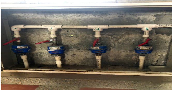
Contador de Agua
