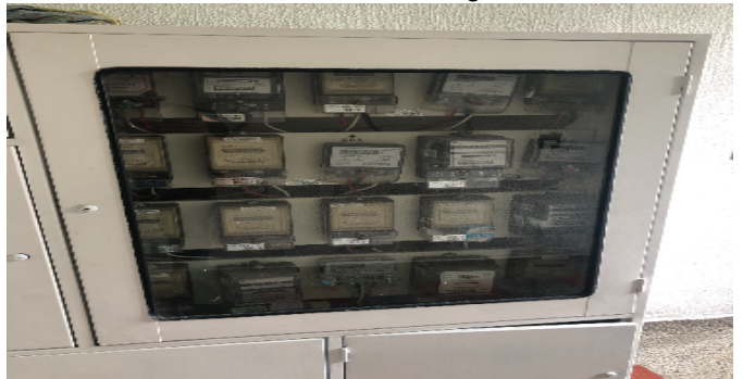
Contador de Energia
