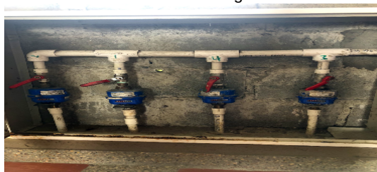
Contador de Agua
