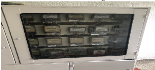
Contador de Energia
