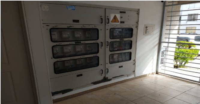
Contador de Energia
