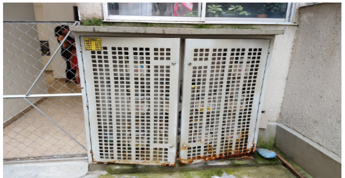
Contador de Gas
