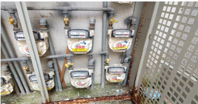
Contador de Gas
