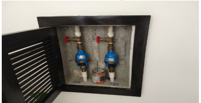
Contador de Agua
