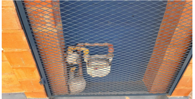
Contador de Gas
