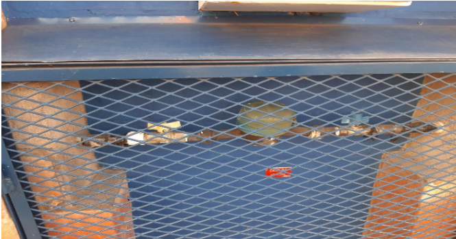
Contador de Agua
