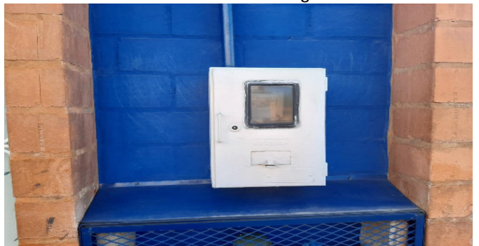
Contador de Energia
