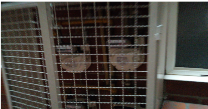
Contador de Gas
