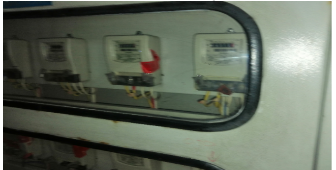
Contador de Energia
