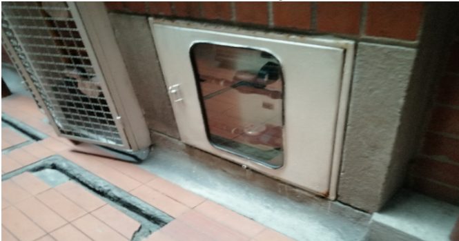
Contador de Agua
