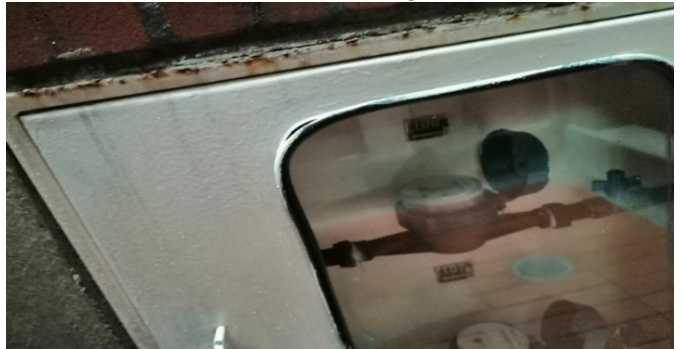
Contador de Agua
