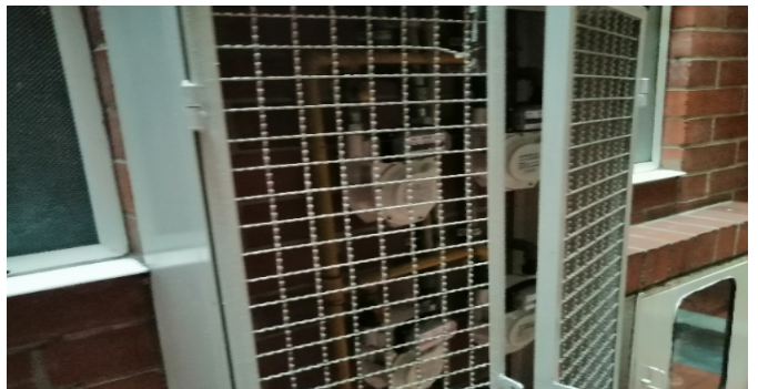
Contador de Gas
