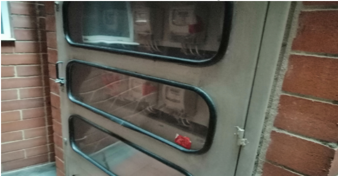
Contador de Energia
