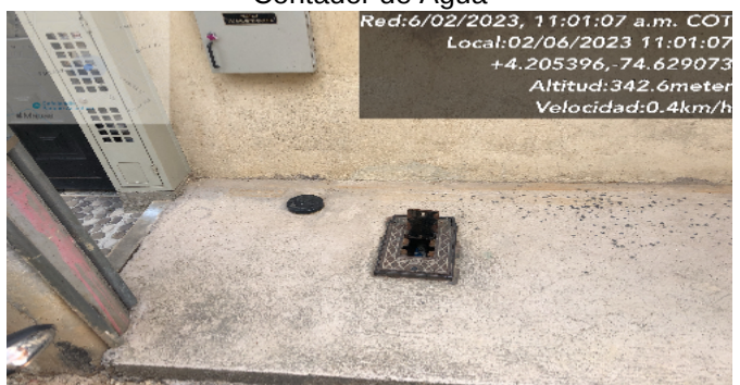
Contador de Agua
