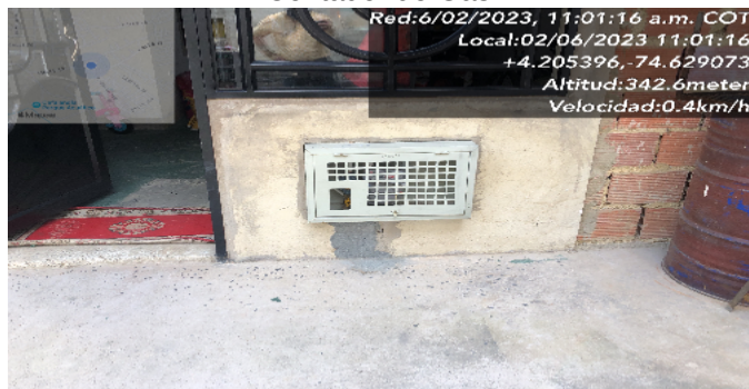
Contador de Gas
