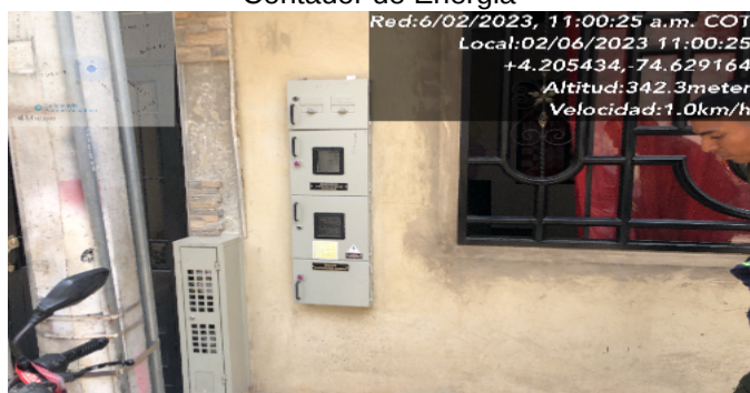
Contador de Energia
