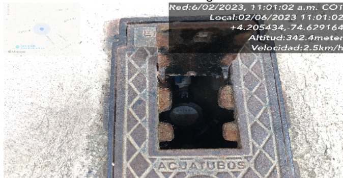
Contador de Agua
