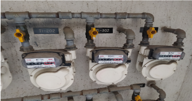
Contador de Gas
