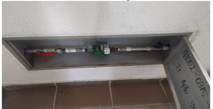
Contador de Agua
