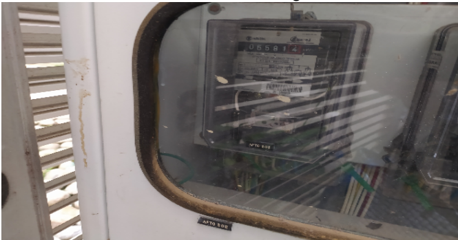
Contador de Energia
