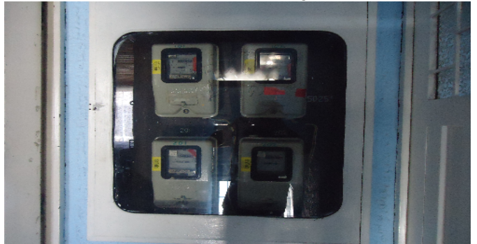
Contador de Energia
