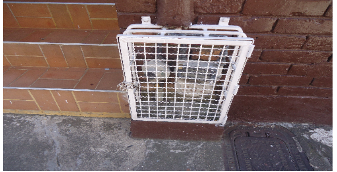
Contador de Gas
