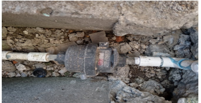
Contador de Agua
