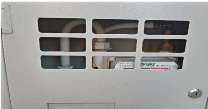
Contador de Gas
