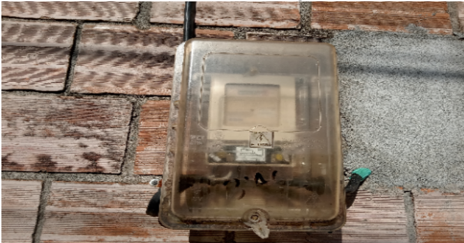
Contador de Energia
