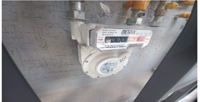
Contador de Gas
