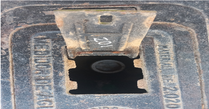
Contador de Agua
