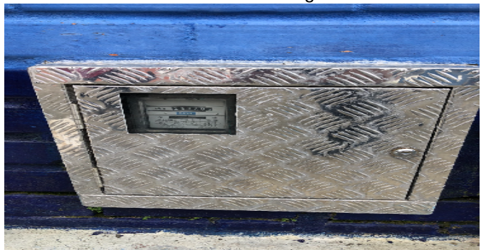
Contador de Energia
