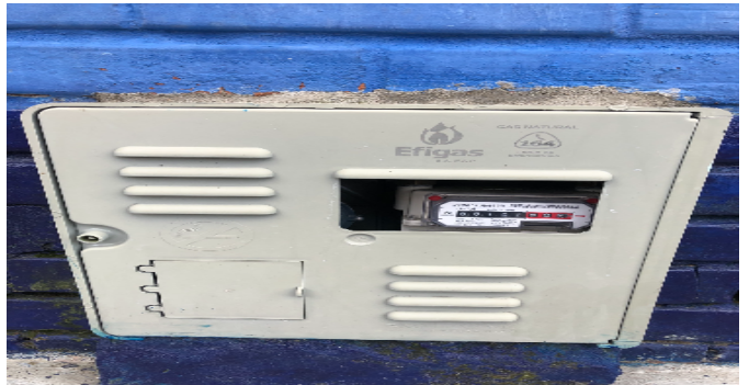
Contador de Gas
