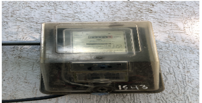
Contador de Energia
