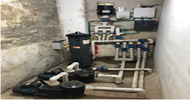
Cuarto de máquinas
