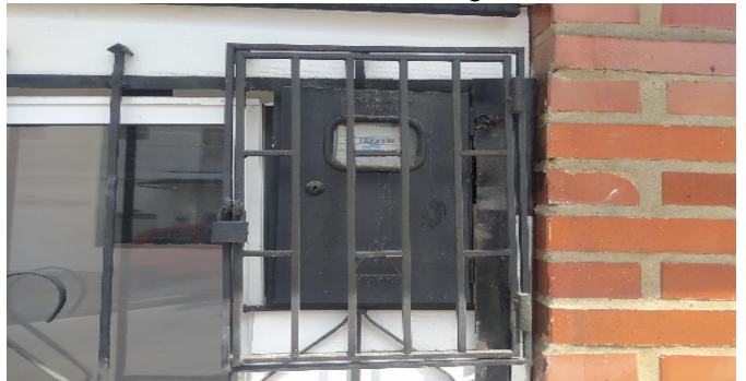
Contador de Energia
