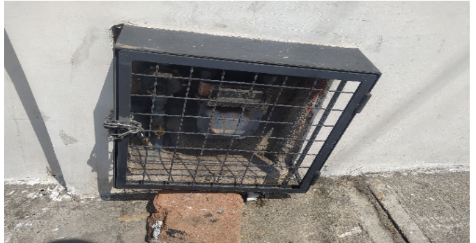
Contador de Gas
