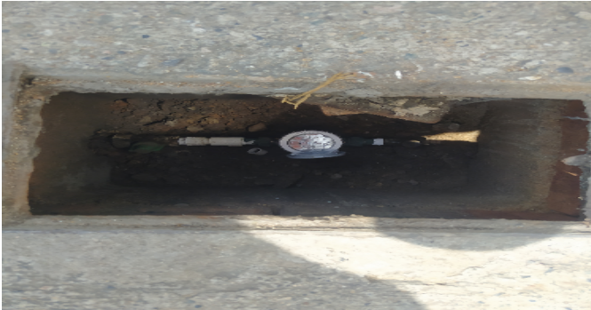
Contador de Agua
