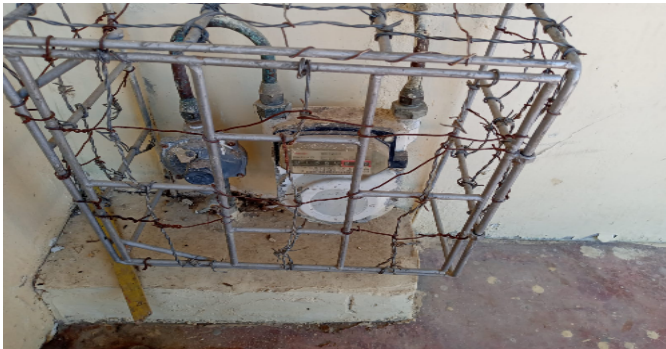
Contador de Gas
