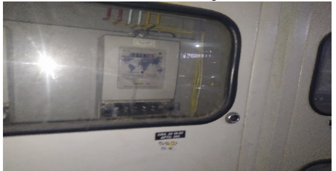
Contador de Energia
