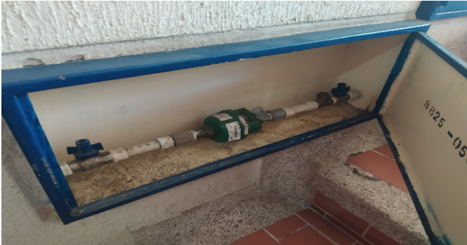
Contador de Agua
