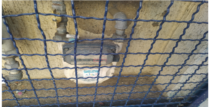
Contador de Gas
