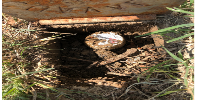
Contador de Agua
