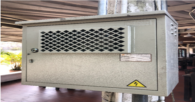
Contador de Energia
