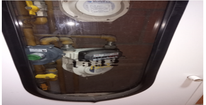
Contador de Gas
