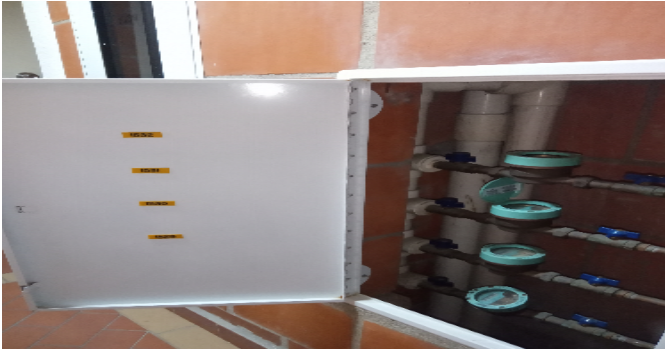
Contador de Agua
