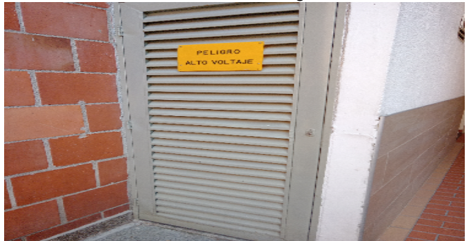
Contador de Energia
